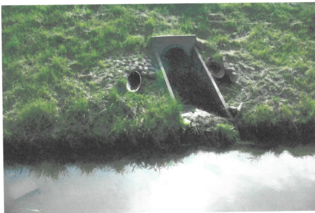
Fot. 12. Wylot kanalizacji deszczowo-burzowej - odcinek I
