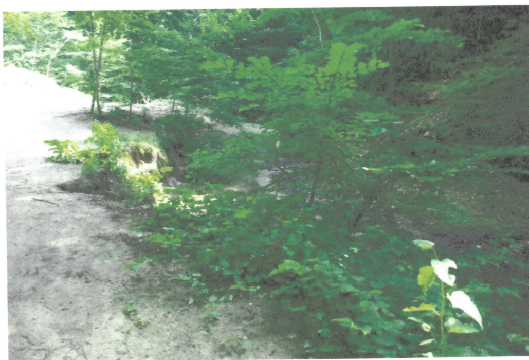
Fot. 9. Erozja brzegowa, stoki porośnięte krzewami - odcinek III
